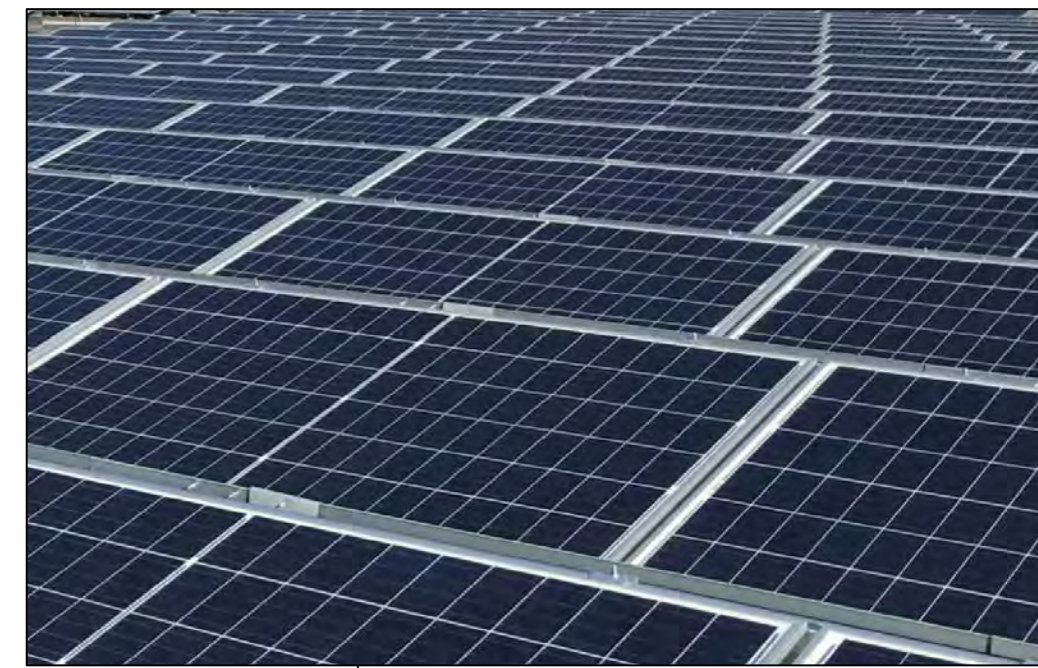
Rooftop solar PV array
